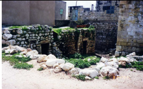
تدهور وتداعي العديد من البيوت السكنية التراثية وبعضها أصبح آيلا للسقوط وذلك بسبب الإهمال وسوء الاستخدام أحيانا
